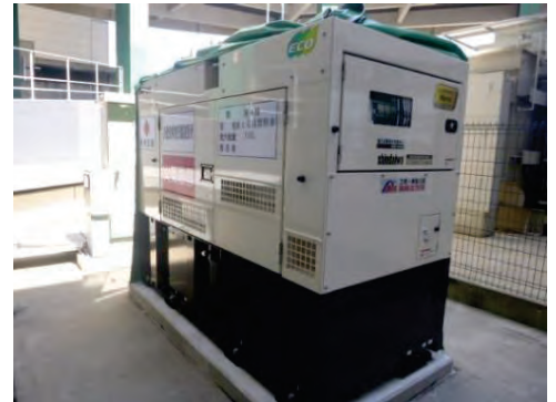
BCP用発電機
